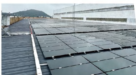
▶ 舟山13MW碲化镉项目
