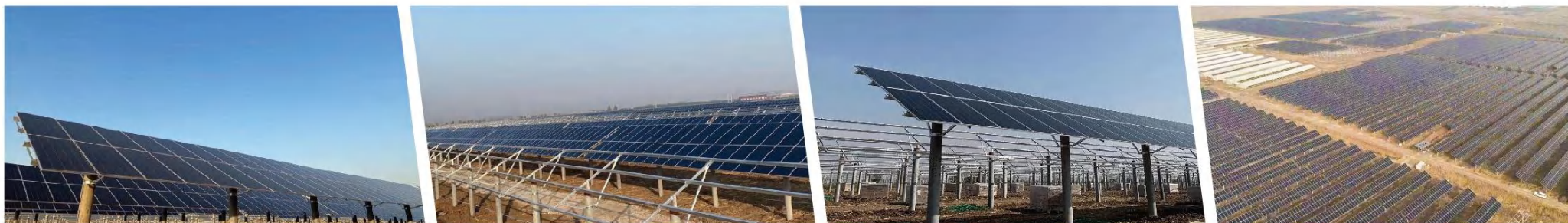
▶ 黑龙江200MWp地面站项目
