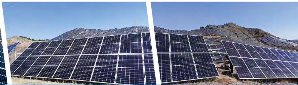
▶ 河北承德地面电站扶贫项目
