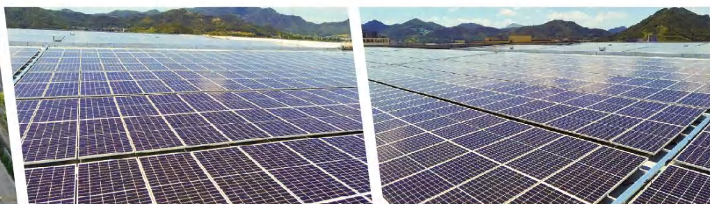
▶ 宁波象山5.7MWp项目
